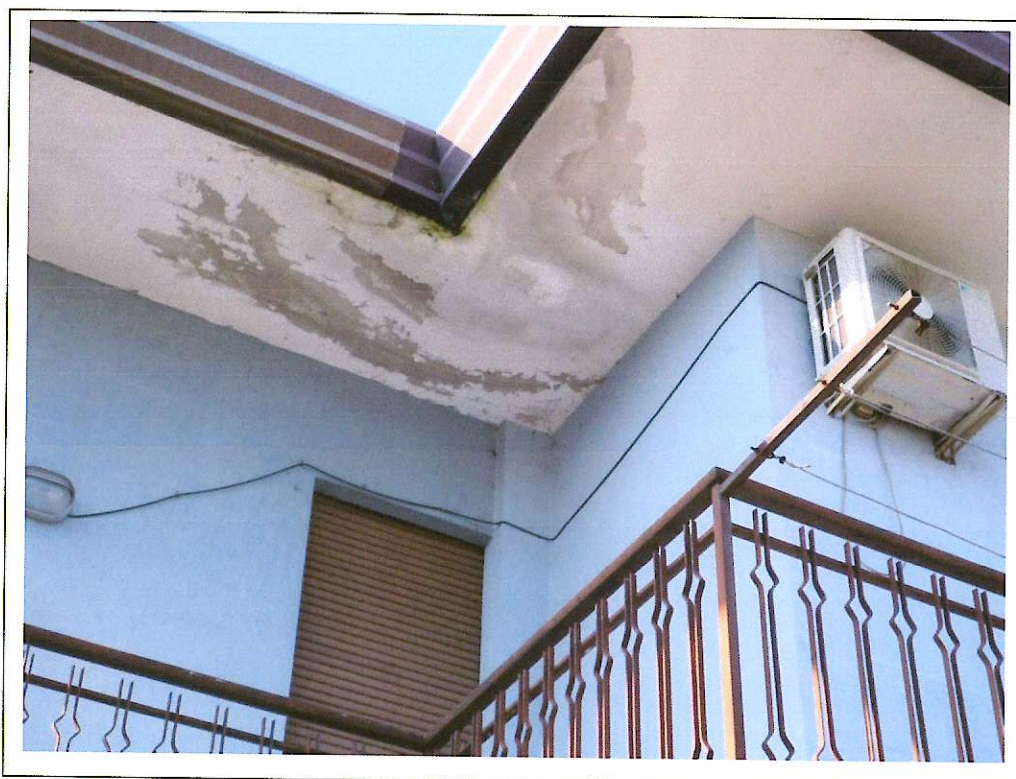
Cornice del tetto con macchie per infiltrazioni d'acqua
